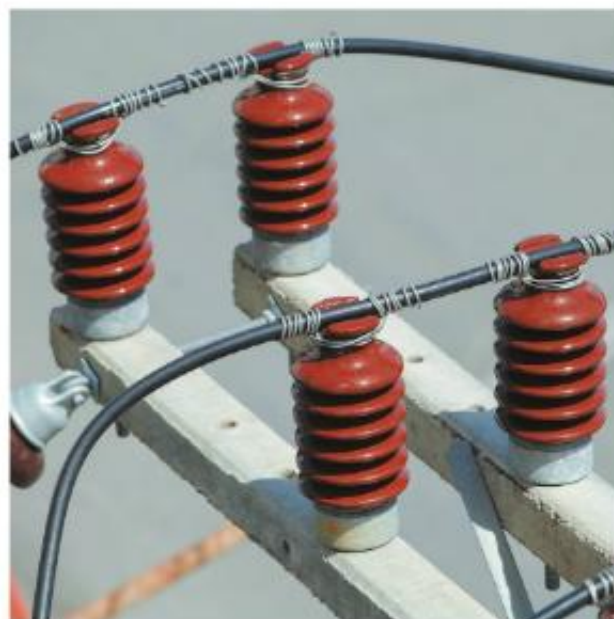
Izolatory ceramiczne na słupie elektrycznym
